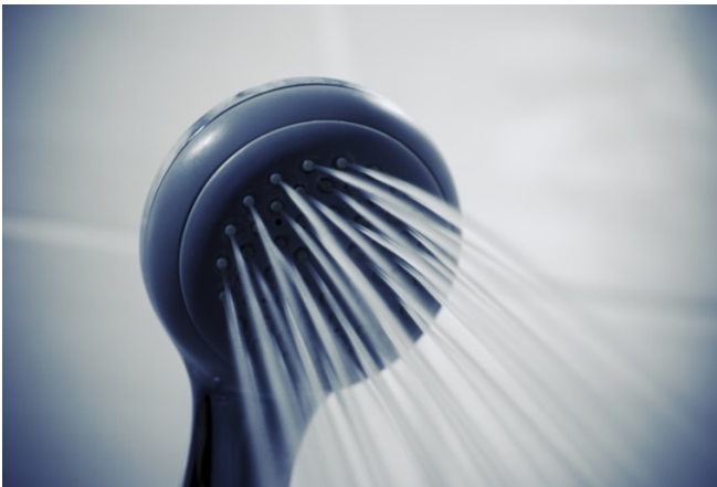
Abbildung 2: Wasser- und Lüftungsanlagen sind bevorzugte Umgebungen von Legionellen.
