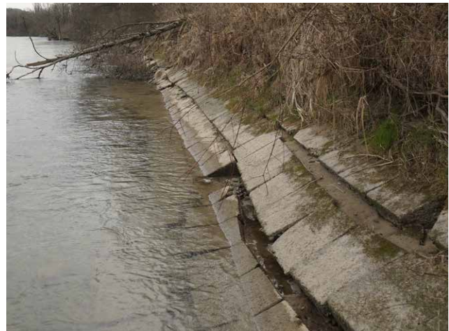
Flächig gepflasterter, nur lokal in Auflösung begriffener Uferverbau am linken Ufer.
