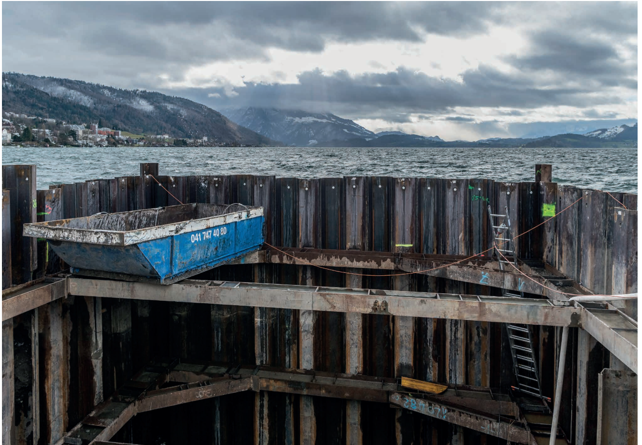
Die grösste Anlage Circulago der WWZ AG nimmt im Jahr 2020 ihren Betrieb auf. Die bewilligte Energienutzung aus dem Zugersee wird erst in einigen Jahrzehnten erreicht sein.
